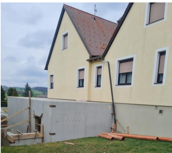
Heizhauszubau – Gemeindegam und Volksschule (Hackschnitzel-Heizanlage // Baufirma: ABau)
